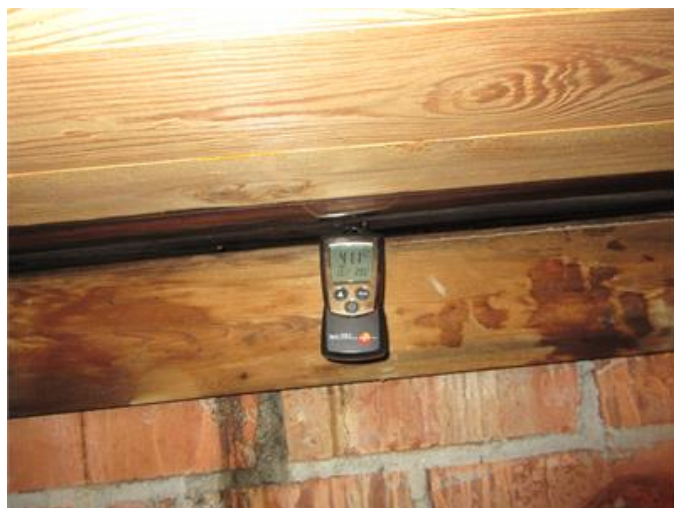
Takläckage i vind
