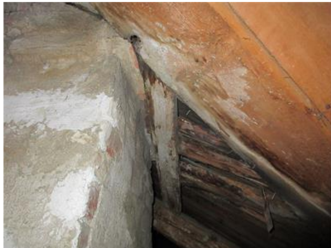
Takbrädor som släppt nedanför skorsten
